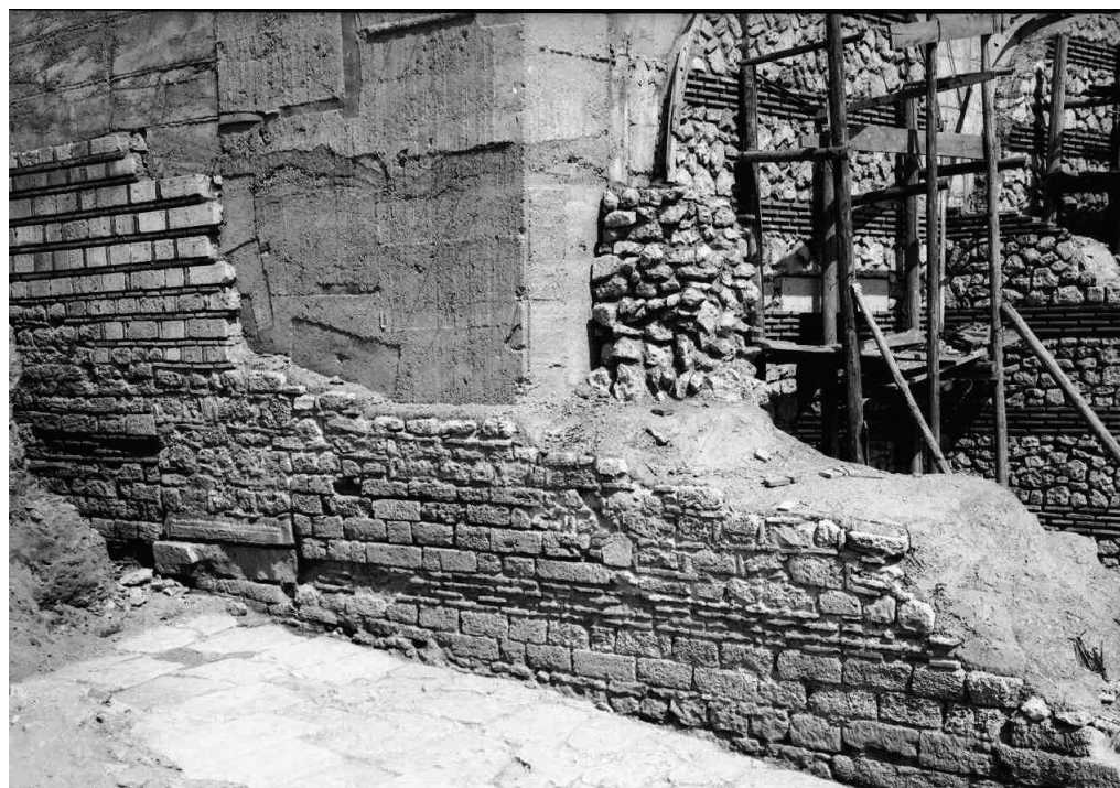
Fig. 34. Zidul de nord-vest păstrat numai la nivelul terasei II. Se pot observa reparațiile ulterioare, precum și intrarea în B 12 zidită (Arhiva fotografică MINAC, cl. nr. 9271).
